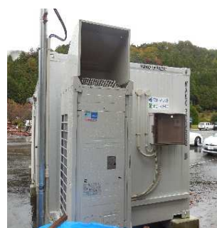
若桜町は積雪が多いため、 庫外ユニットには 防雪フードを取付け
