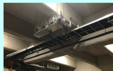
↑ 庫内機 (通路の上に設置)
